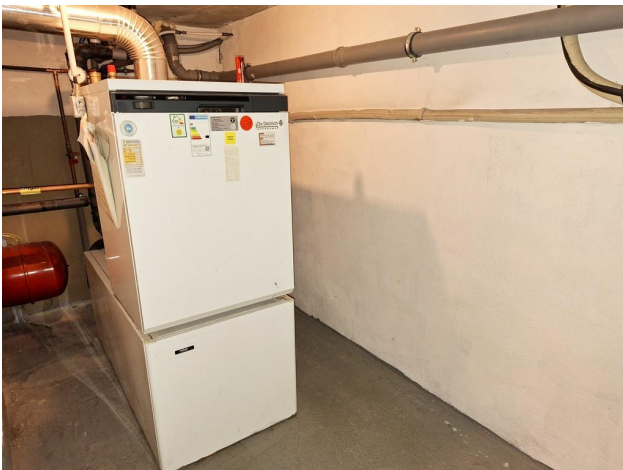
Gastherme mit Warmwasseraufbereitung
